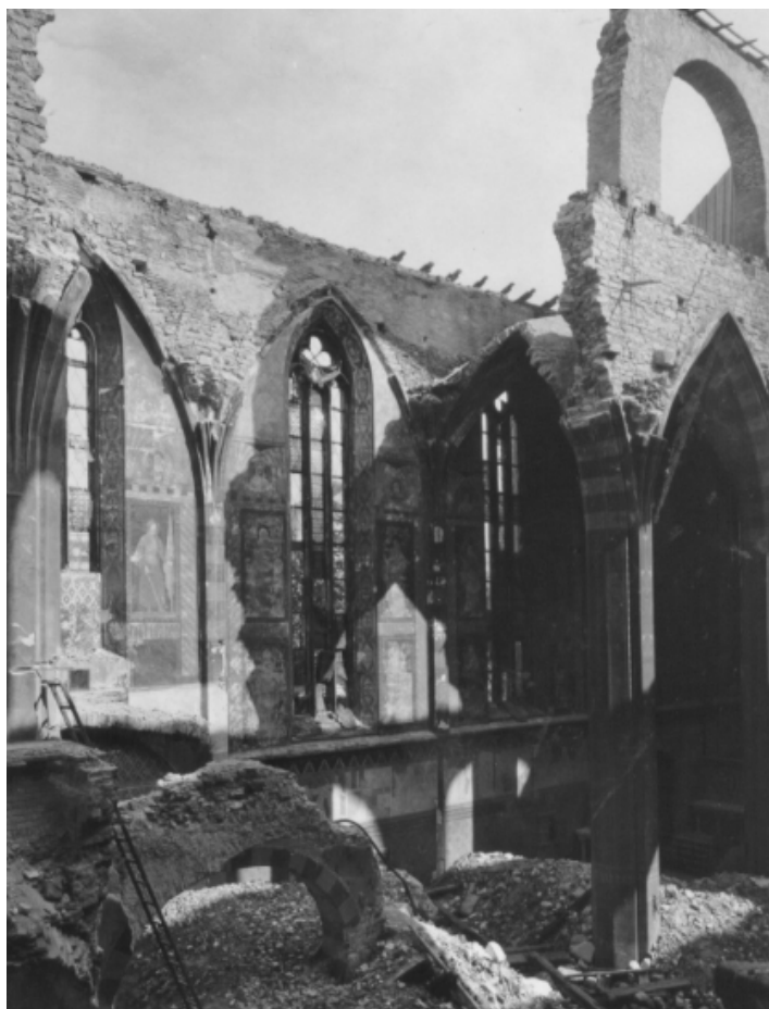
Obr. 29 Následky spojeneckého náletu IV., pohled na severní stěnu z interiéru (nedatováno)
