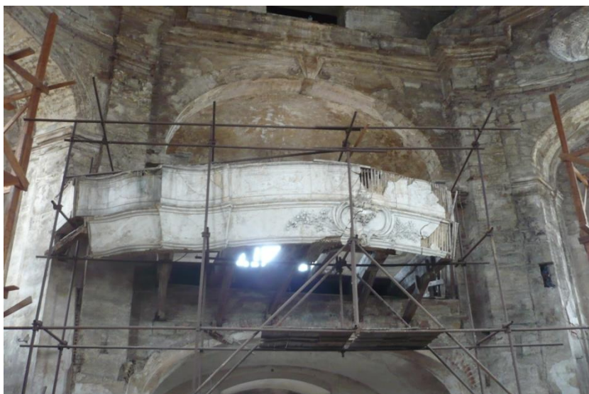
16. Rozbělesy , kostel sv. Václava, 1731–1783, pohled na pozůstatky varhanní kruchty
