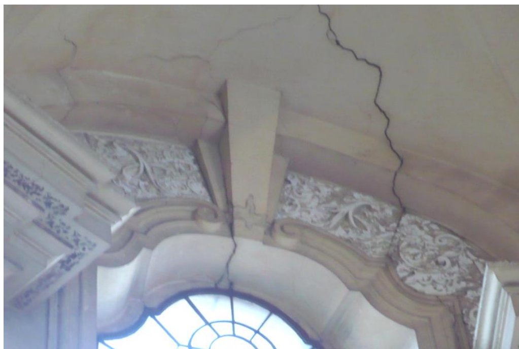
54. Arnoltice , kostel Nanebevzetí Panny Marie, 1756–1758, detail trhlin severního okna presbytáře
