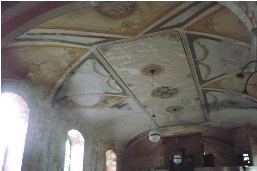
39. Bělá , kostel sv. Františka Xaverského, 1788, pohled na vyspravenou klenbu hlavní lodi
