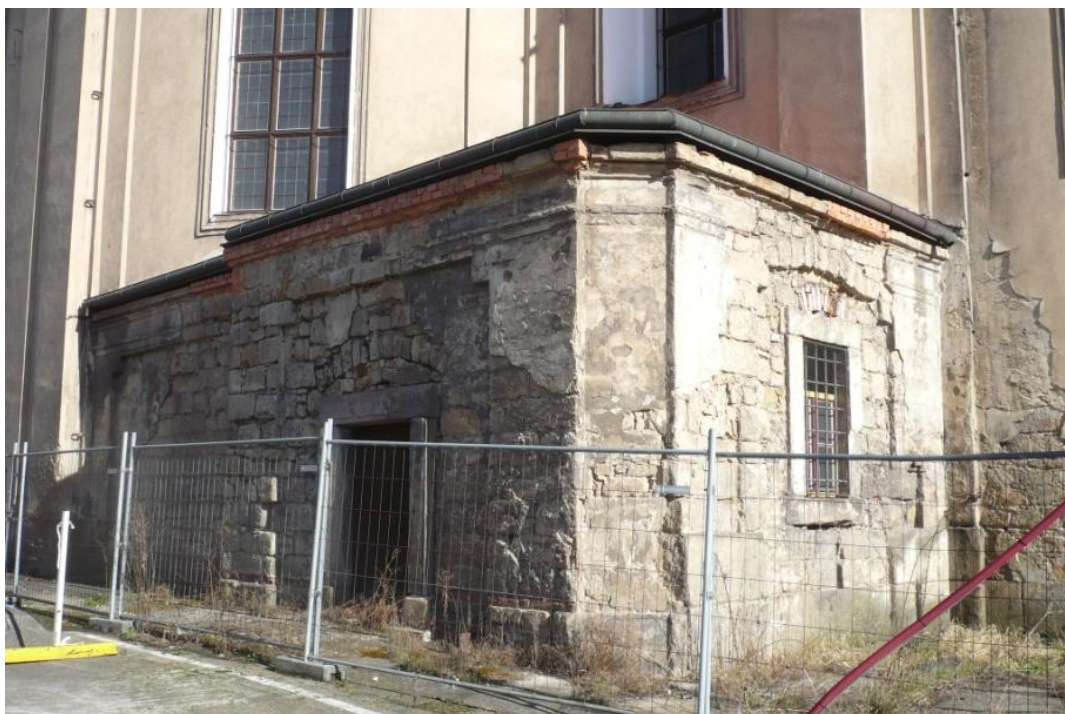
22. Rozbělesy , kostel sv. Václava, 1731–1783, pohled na jižní sakristii z jihovýchodu s patrnými nešetrně provedenými cihlovými dozdívkami římsy
