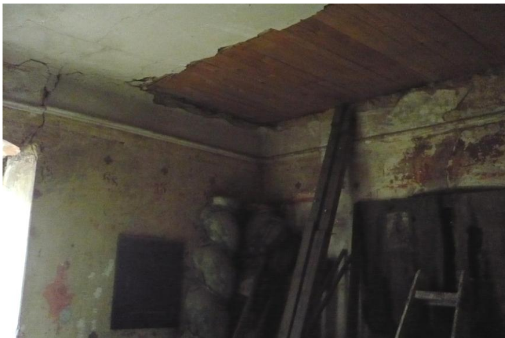
35. Bělá , kostel sv. Františka Xaverského, 1788, pohled na zřícený strop sakristie
