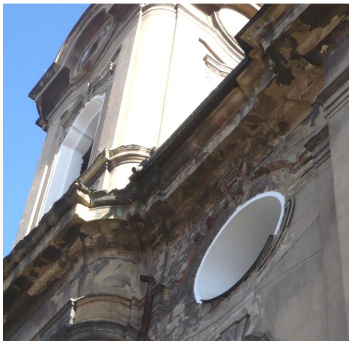
19. Rozbělesy , kostel sv. Václava, 1731–1783, pohled na vlhkostí poškozené omítky v západní části jižní stěny lodi, na snímku jsou patrné i pozůstatky starých okapních svodů, jež zatím nebyly nahrazeny
