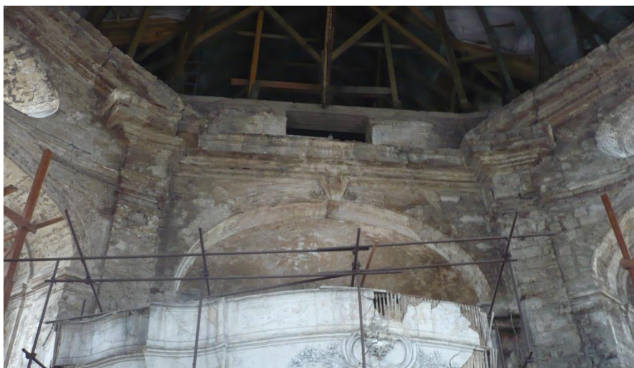
18. Rozbělesy , kostel sv. Václava, 1731–1783, pohled na vlhkostí poškozenou horní část západního zdiva interiéru
