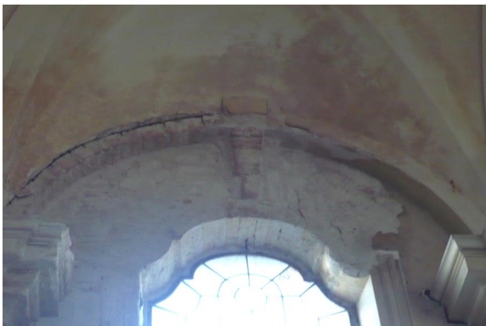
55. Arnoltice , kostel Nanebevzetí Panny Marie, 1756–1758, detail trhlín a stavu omítek severního okna hlavní lodi
