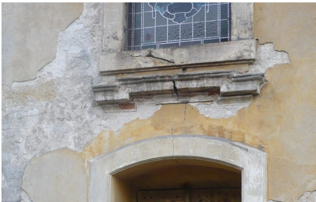
36. Bělá , kostel sv. Františka Xaverského, 1788, trhlina nad bočním portálem v severní stěně hlavní lodi
