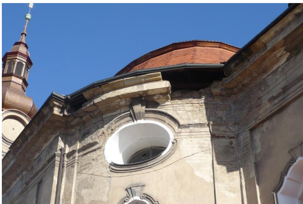
15. Rozbělesy , kostel sv. Václava, 1731–1783, jihovýchodní nároží, detail chybějících úseků hlavní římsy
