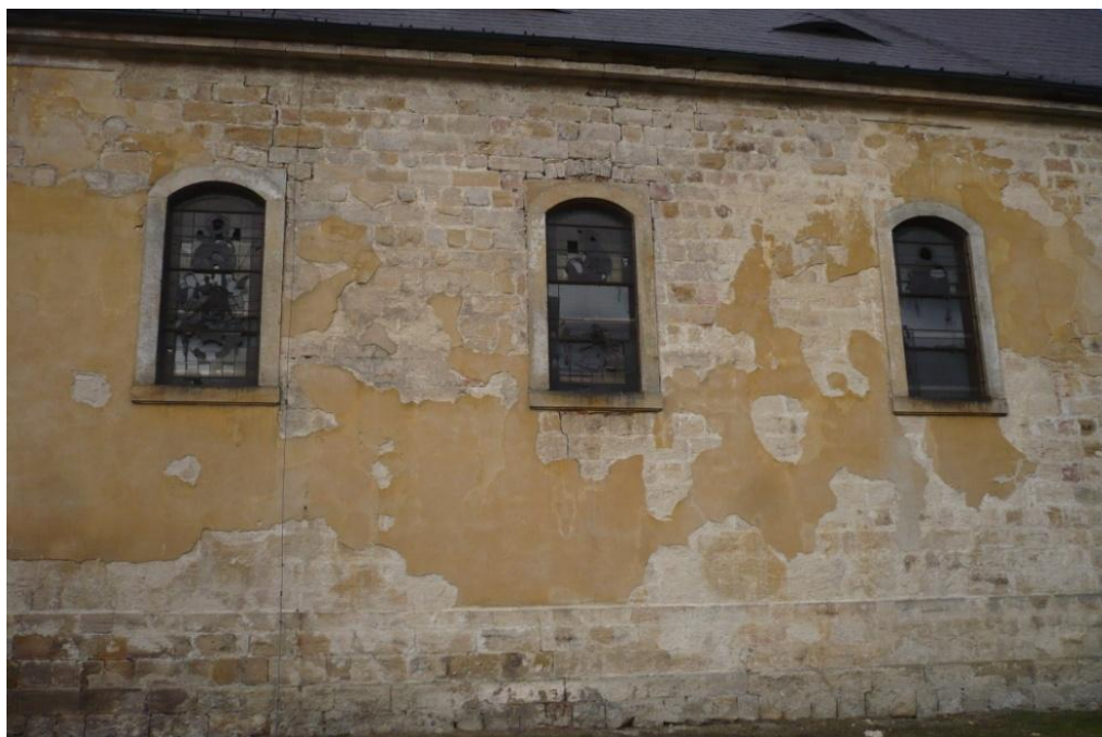
37. Bělá , kostel sv. Františka Xaverského, 1788, pohled na opadané fasády jižní stěny lodi
