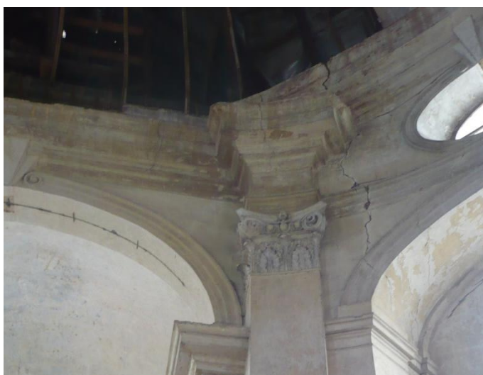
17. Rozbělesy , kostel sv. Václava, 1731–1783, trhlina jihovýchodního nároží
