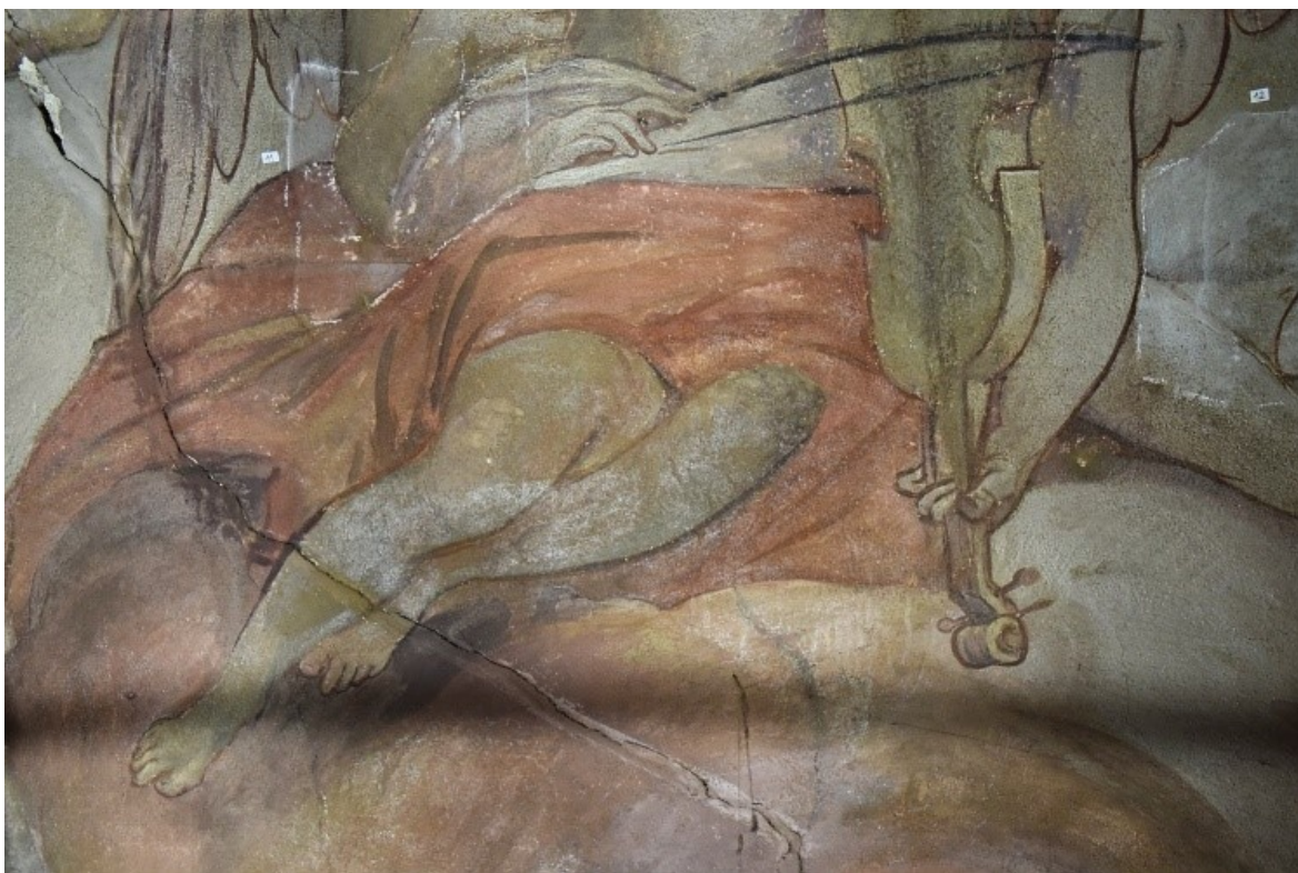
Obr. 43 - Detail poškození kupole – prasklina a vypadlý kus omítky s barvou
