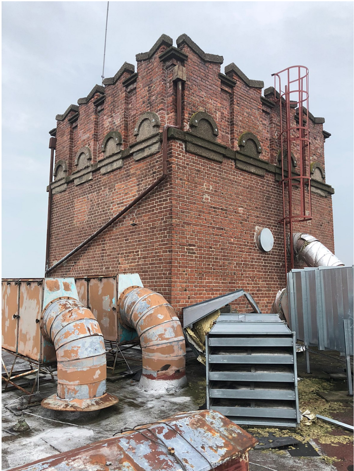
27. Vodní věž s umístěnou vzduchotechnikou, současný stav
