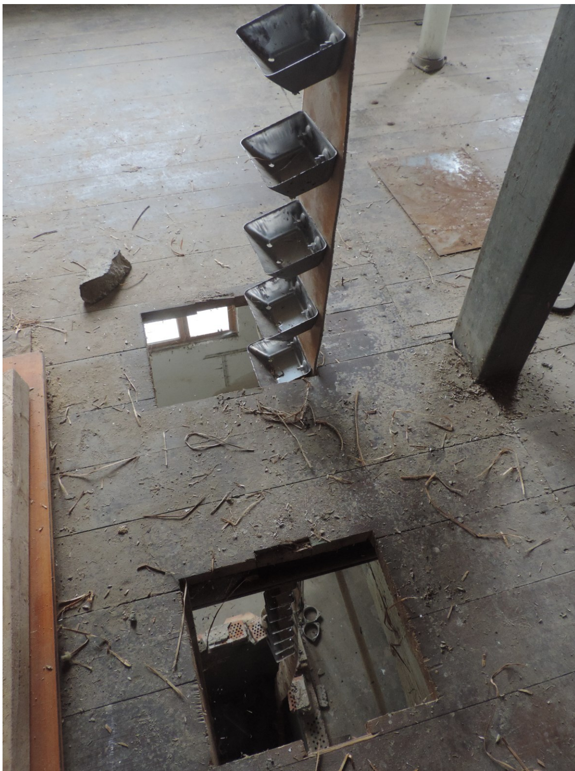
12. Vnitřní pás korečkového dopravníku, současný stav
