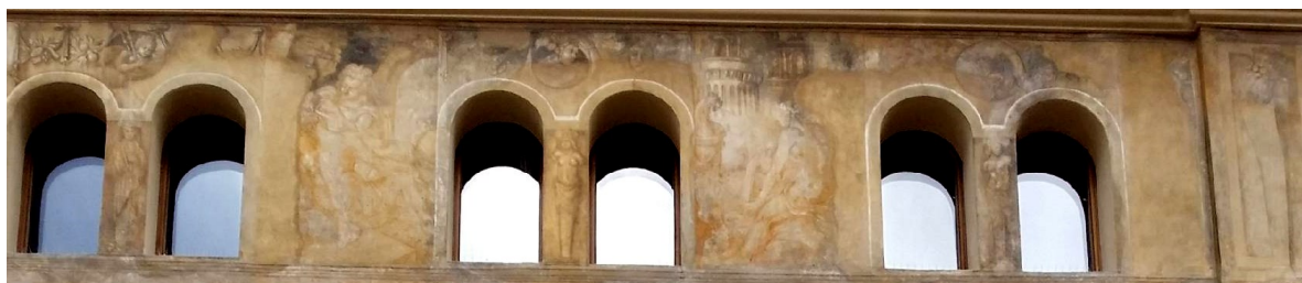
16. Praha , Staré město, palác Granovských z Granova, po 1565, pohled na sdružená okna zasažená destrukcí v 18. století
