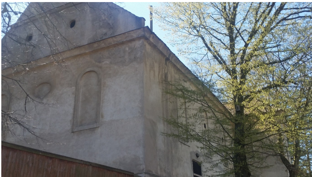
Obr. 25. budova bývalé synagogy, později kina. Dnes je objekt trvale uzavřen a chátrá.
