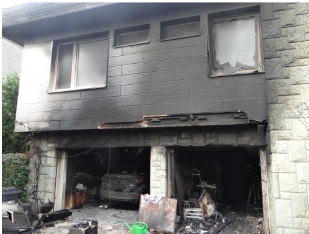
Obrázek č. 14 – Dvojaráž a rodinný dům po požáru
