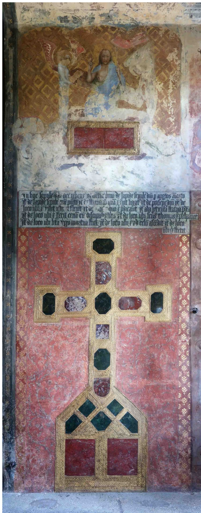
Obr. v 12. Karlštejn, menší věž, kaple Panny Marie. Crux gemmata a Boží hrob v okenním výklenku přiléhající ke kapli sv. Kateřiny (původně kaple Umučení a jejich Nástrojů). Foto Petr Uličný.
