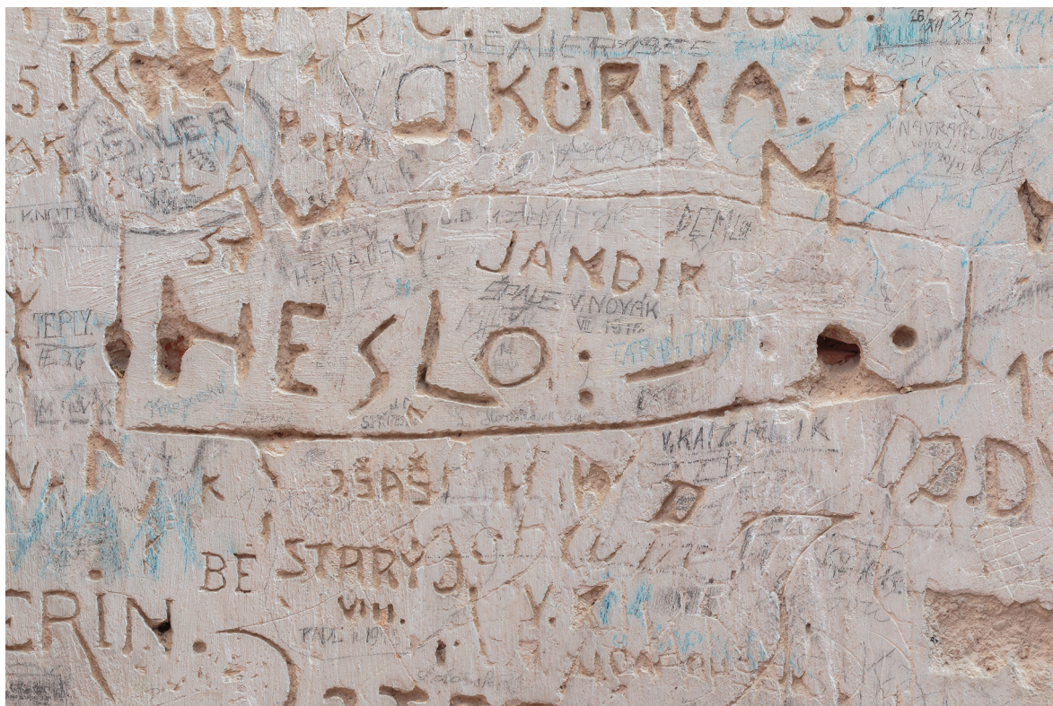
Obr. 124 Piaristický chrám, kruchta, stěna za varhanami. „Busy graffiti surface“. Foto: Vojtěch Krajíček.
