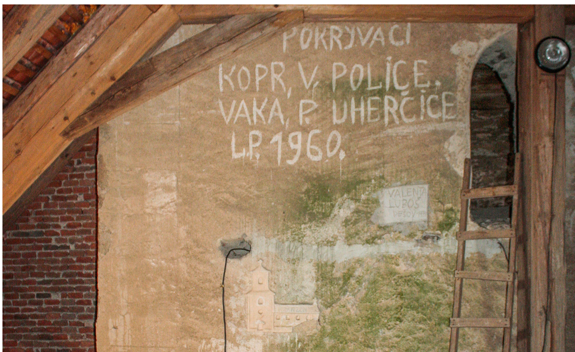
Obr. 39 Rancířov, kostel Nanebevzetí Panny Marie, krov. Plastické znázornění kostela ve štuk, „3D graffiti“. Foto: Zdeněk Kovářík.
