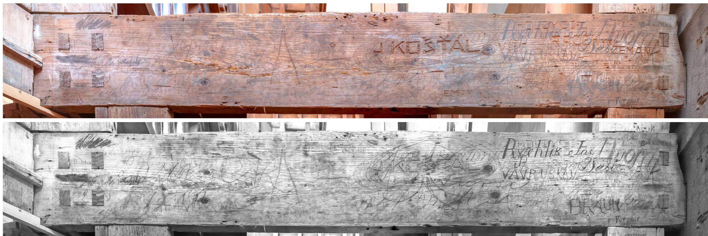
Obr. 118 Piaristický chrám, kruchta, varhany. Hustě popsaný konstrukční prvek varhan situovaný ve vnitřním prostoru varhanní skříně hlavního stroje. Foto: Vojtěch Krajčů
