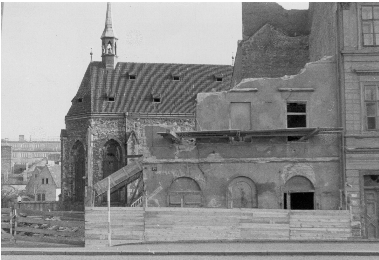
777. Demolice domu čp. 840-I na Dvořákově nábřeží, v pozadí chór kostela nejsv. Salvátora, 1958, I 859
