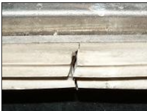
obrázek č.1. Prasklina v těsnění
