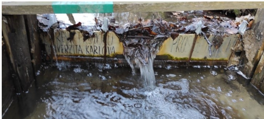
Obr. 3.11: Přeliv na Pšovce 2.3.2022 před pročištěním (Foto autor)
