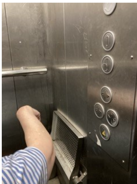
Panel ovládání výtahu, stanice metra Můstek
