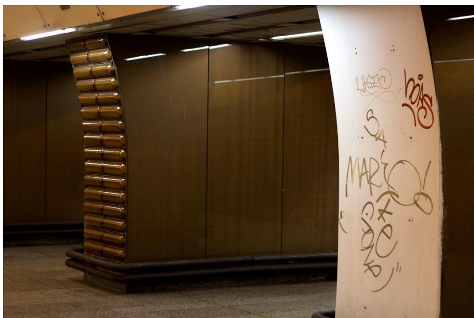
102. Stanice metra Jinonice, chybějící obložení, stav z listopadu 2016, Praha
