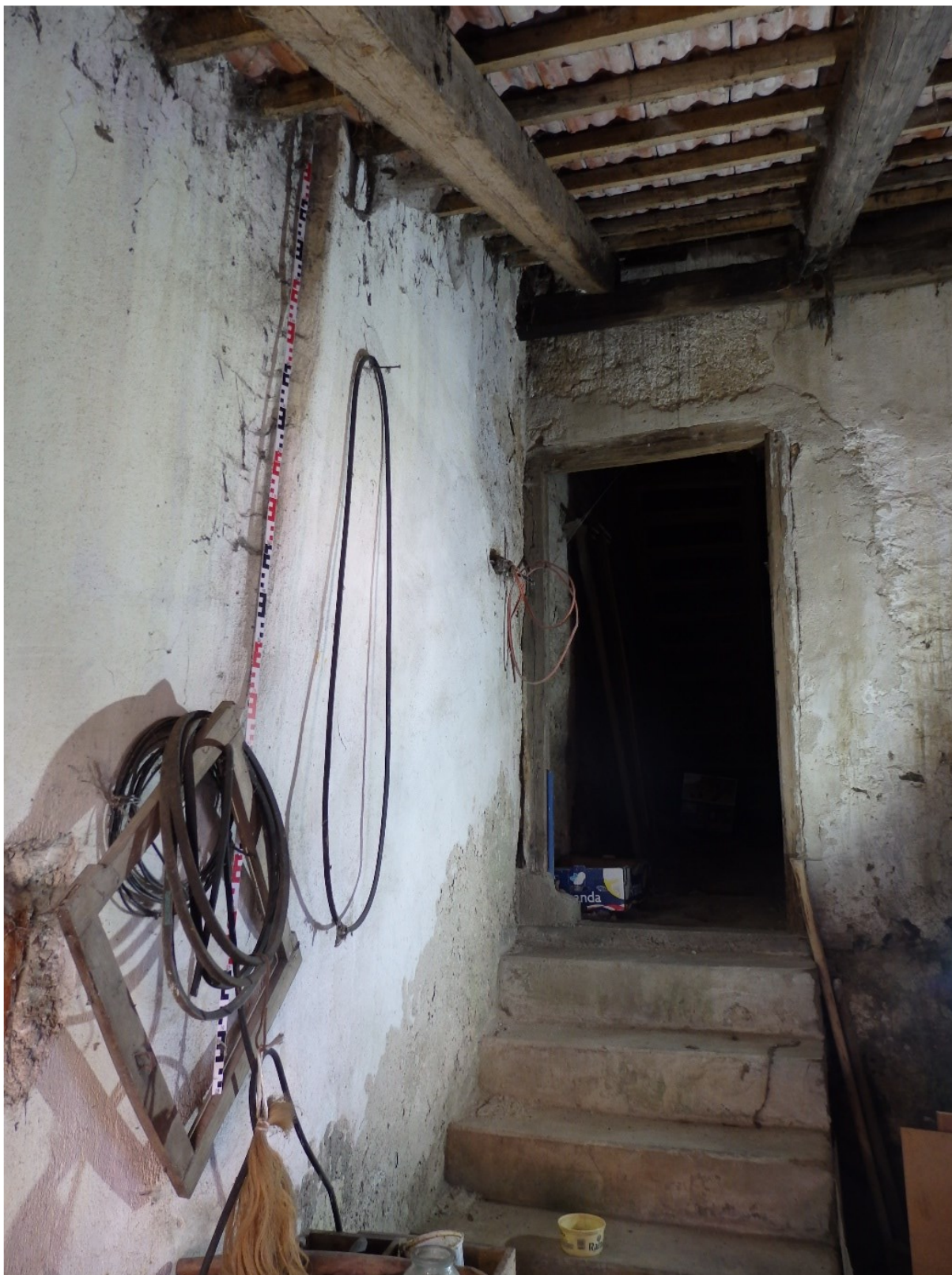
41) Pohled do předsíně sýpky, vlevo skarpovité zesílení zaniklého malého stavení , viz předešlá fotografie, 2022.
