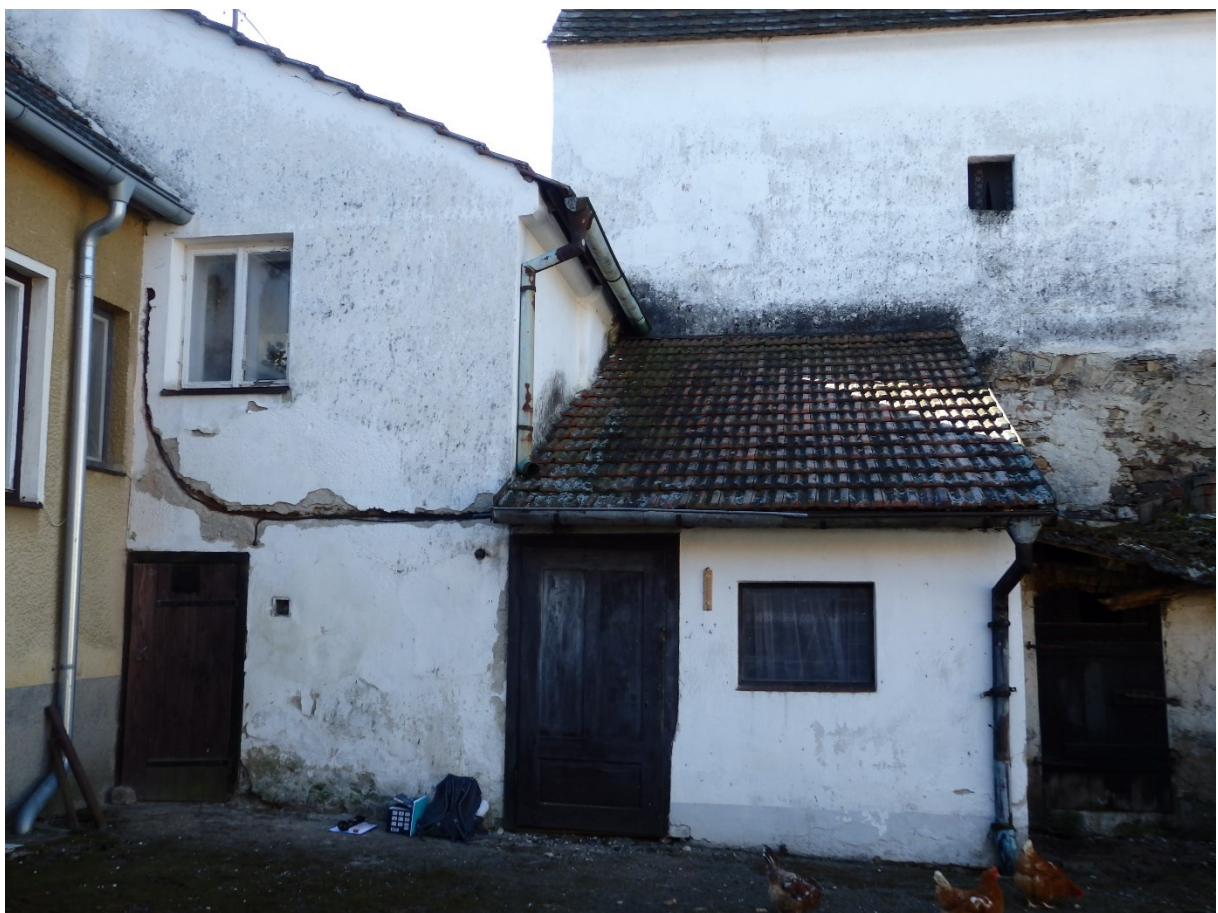
15) Podsklepený přístavek (vlevo), s předsíní sýpky (vpravo) a sýpkou, pohled ze dvora, ze severu, 2022.
