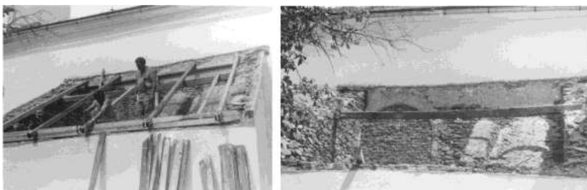
Obr. 23 Horní Město, kostel sv. Marie Magdaleny, podkroví jižní předsíně při opravě. (Foto: B. Měchura, 1983, sbírka Římskokatolické farnosti Horní Město)
