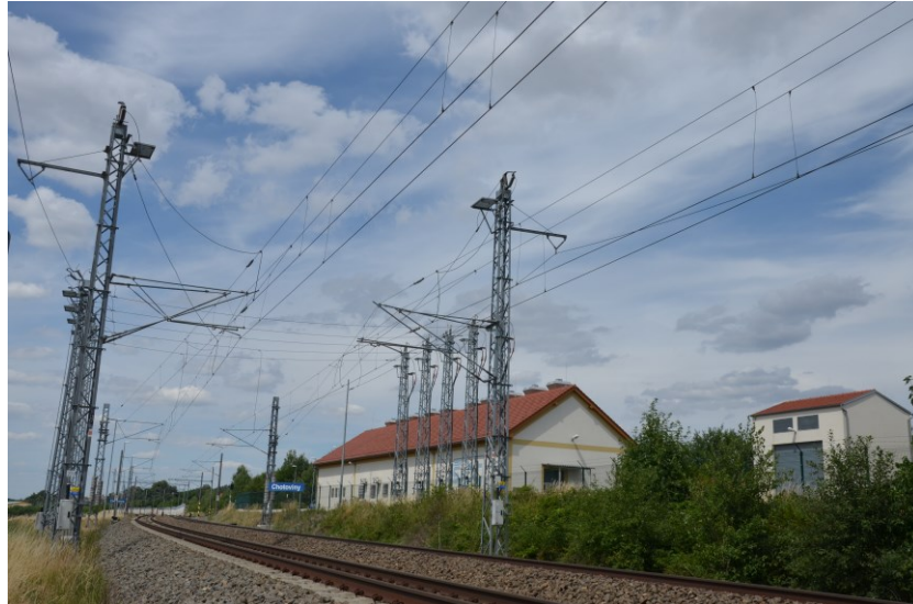
Obrázek 30: Trakční transformovna nedaleko stanice Chotoviny. Mezi čtyřmi stožáry, jež jsou blízko u sebe, jsou troleje napájeny přívodními vodiči. Na stožárech se pak nachází odpojovače (podkapitola 2.5.1).
