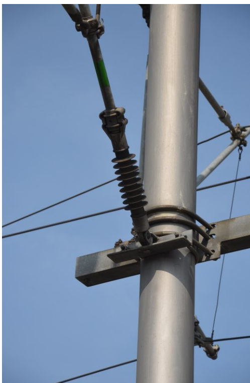
Obrázek 31: Izolátor na trolejovém vedení. Izolátor je tvořen nylonovým jádrem a gumovými prstenci, na nichž se neudrží souvislá vrstva vody.
