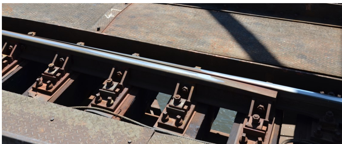
Obrázek 11: Dilatační zařízení na železničním mostě v pražské Výtoni.
