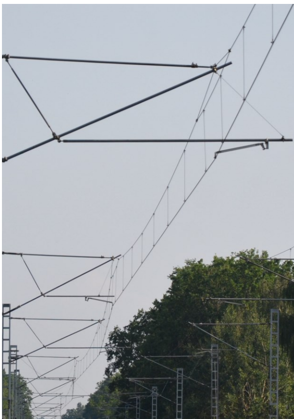
Obrázek 17: Detail řetězovkového vedení. Je vidět, že je horní nosné lano prověšené.
