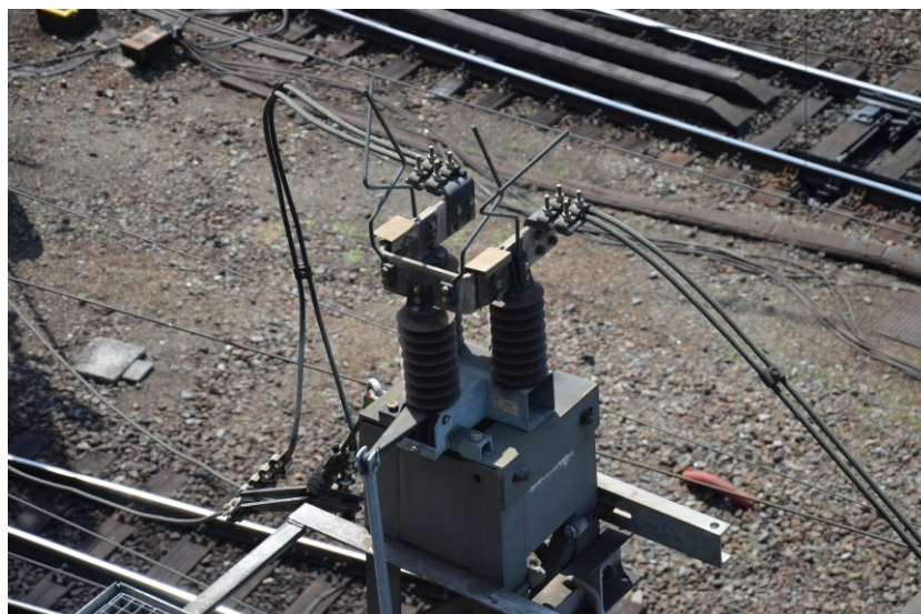
Obrázek 37: Úsekový odpojovač na Hlavním nádraží v Praze. Zprava je k odpojovači přiveden vodič spojený s trolejí před děličem, vodivě je propojen s odklápěcí částí děliče, ta pak vodivě s levou stranou. Z této části je pak vyveden vodič připojený k troleji za děličem.
