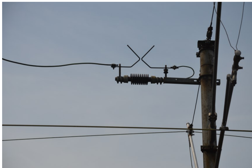
Obrázek 26: Růžková bleskojistka na stejnosměrném systému. Levá část je připojena k troleji, pravá přes stožár uzemněna. Oba růžky jsou odděleny izolátorem.
