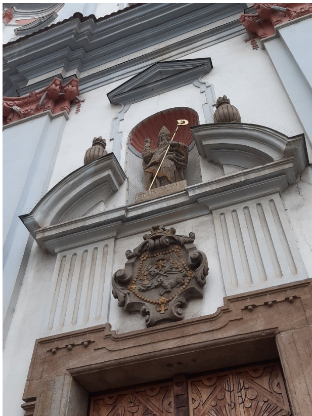
Obrázek č. 4: Detail: Symbol dominikánů na průčelí bývalého konventního kostela sv. Vojtěcha v Ústí nad Labem (stav z listopadu 2021).
