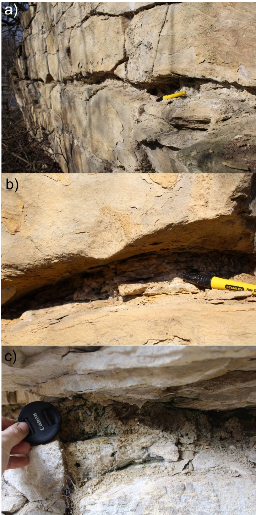
Obr. 7-5 Příkladů zcela rozvětralého a rozpadavého materiálu na vrstevních plochách, jehož vymytím mohou vznikat subhorizontální otevřené trhliny pozorované karotáží v přítokových kavernách vrtů. a), b) Choceň nad nádražím, kolektor Cb, c) Nové Hrady kolektor B
