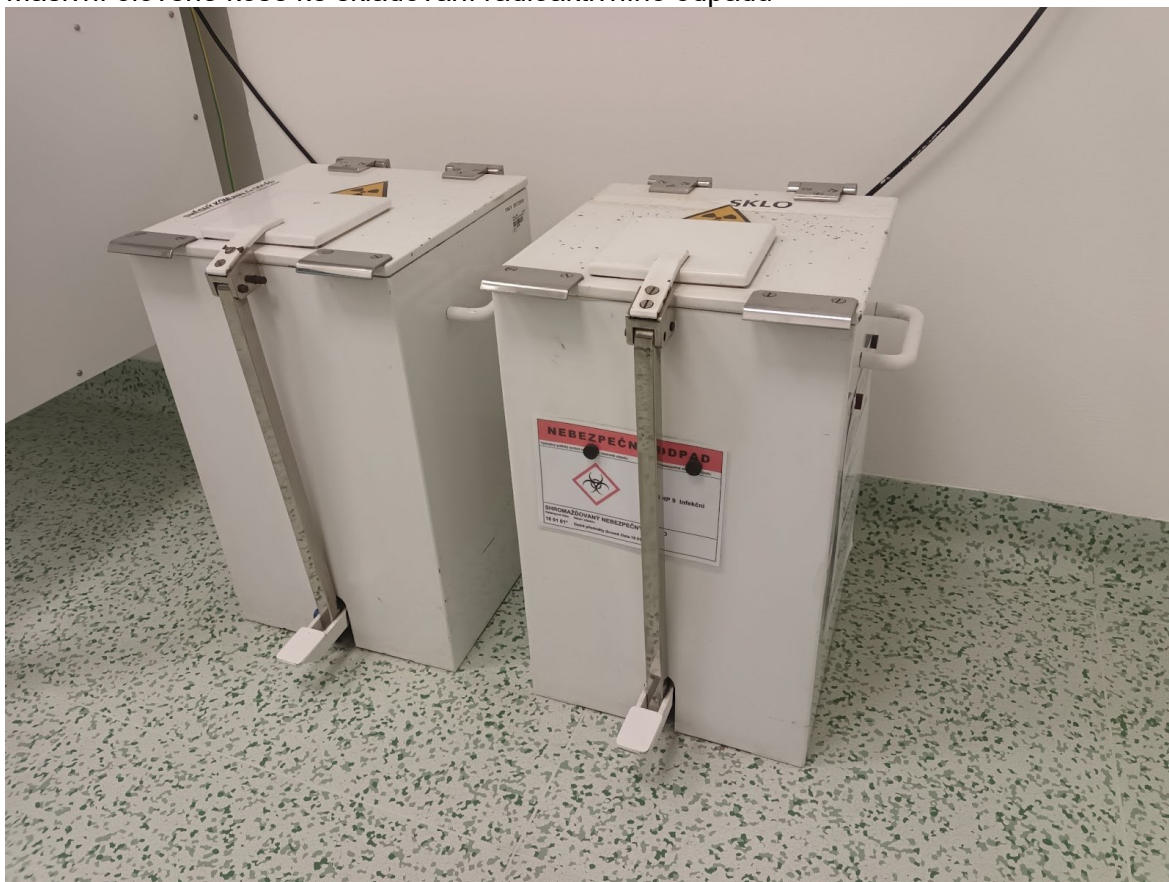
Masivní olověné koše ke skladování radioaktivního odpadu
