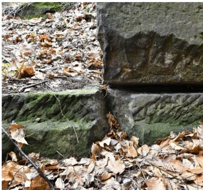
Obr. 4: Detail šrámu v lomu Elbtalstrassebruch
