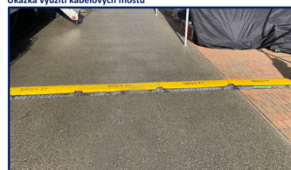
Ukázka využití kabelových mostů
