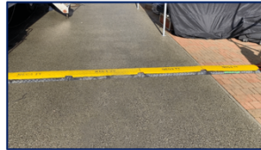
Ukázka využití kabelových mostů
