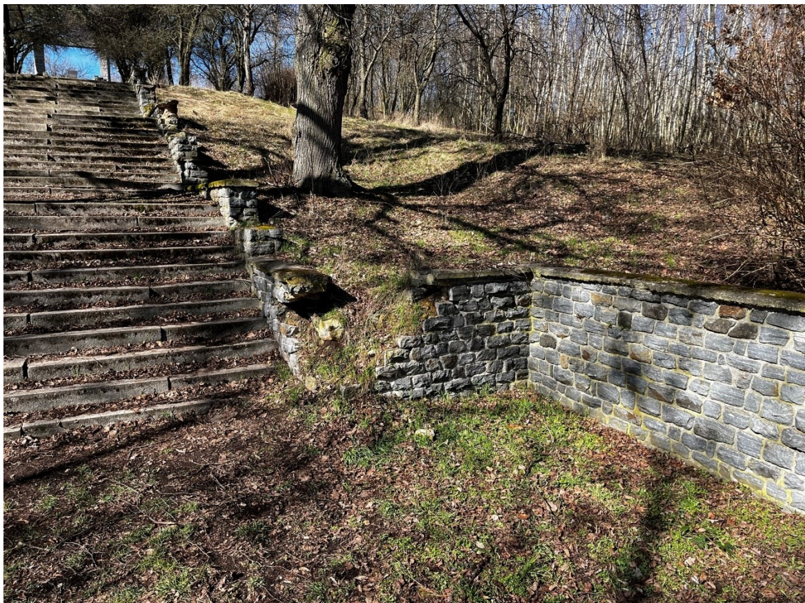
Příloha č. 307: Dnešní podoba památníku. 1137 Zejména schodiště již je velice špatném stavu.
