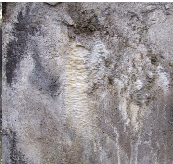
Obr. 6: Vápenaté výkvěty ze stěny pěchotního srubu Mústek.
