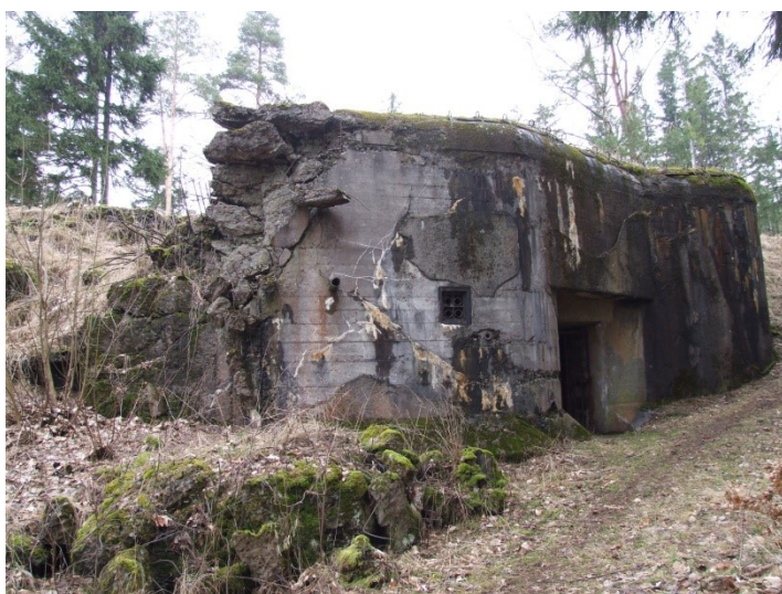
Obr. 13: Poškození pěchotního srubu Hrobka vzniklé vytržením pancěřového zvonu.
