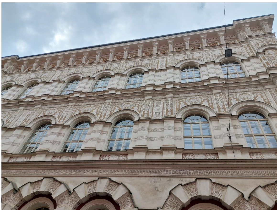
42. Budova bývalé Vyšší dívčí školy, Praha: Pohled na boční fasádu z ul. Školská
