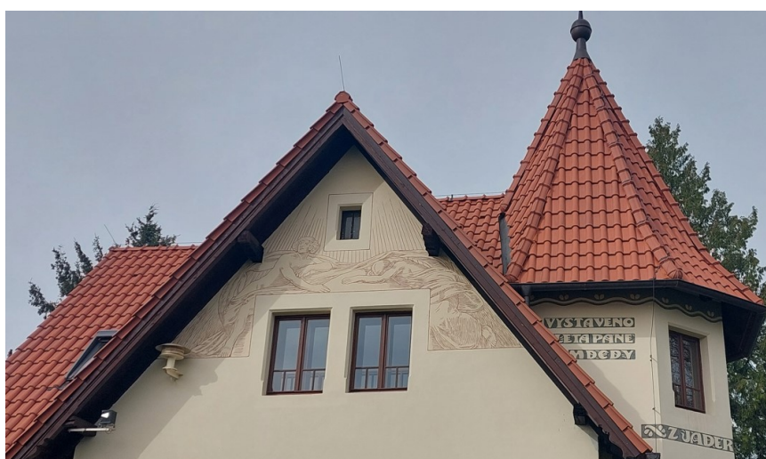
59. Domek s pracovnou Josefa Jana Friče, Hvězdárna Ondřejov: Detail alegorie Poledne života na jižní fasádě a nápisů na věži
