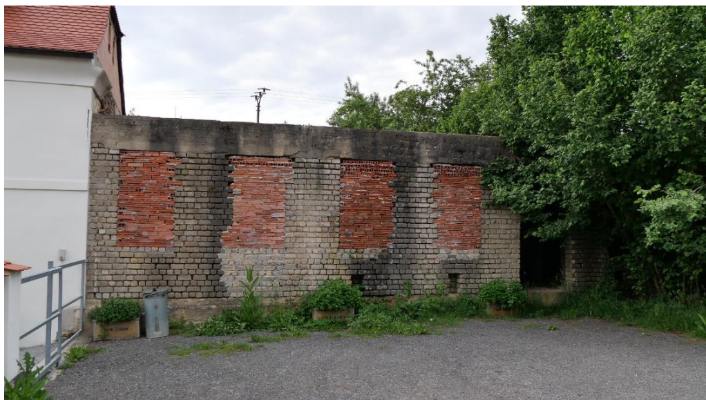
Obrázek 14 - Dnešní podoba nedostavěné budovy (v dnešní ulici „Benešovská“), jež měla podle obecní kroniky sloužit zřejmě jako pošta a její sklepní část pak zase jako kriminál pro provinilé vojáky. Podle síly základů a dochovaných schodišť měla být budova v její konečné podobě zcela jistě vícepatrová. Archiv autora
