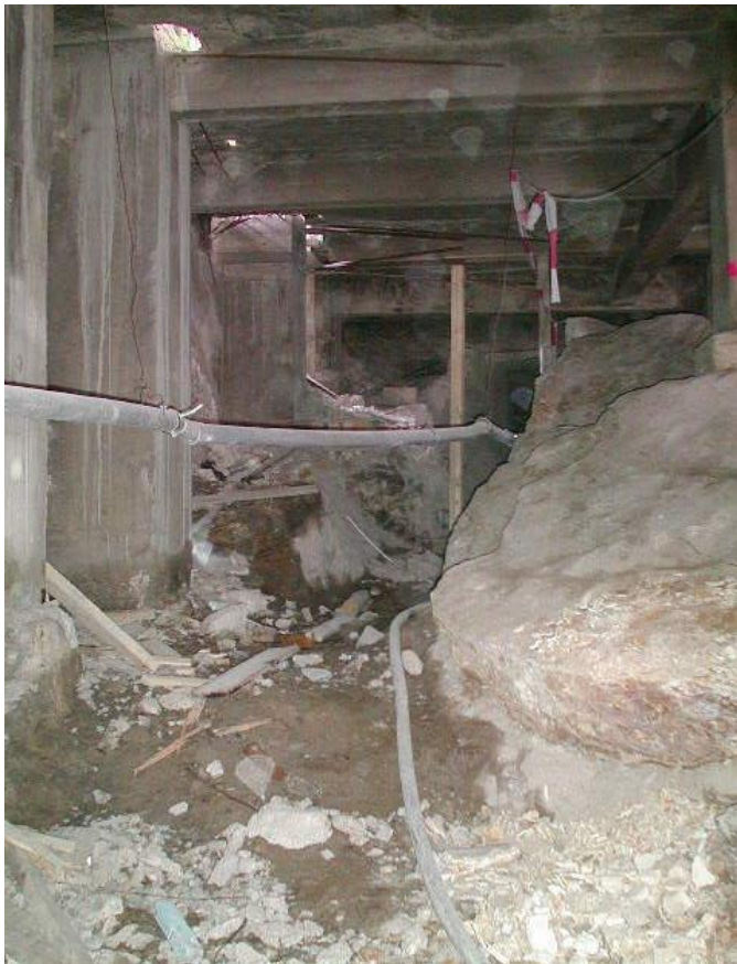
Obr. 4 Hlavní trhlina v prostoru Zámeckých pramenů.
