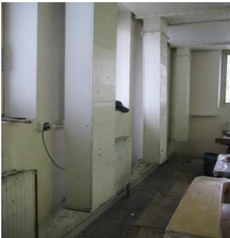
Obrázek 9 – odtah znečištěného vzduchu z dílny ruční laminace
