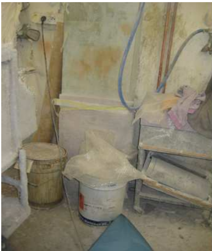
Obrázek 10 – potrubí na odtah znečištěného vzduchu (nevyhovující stav)
