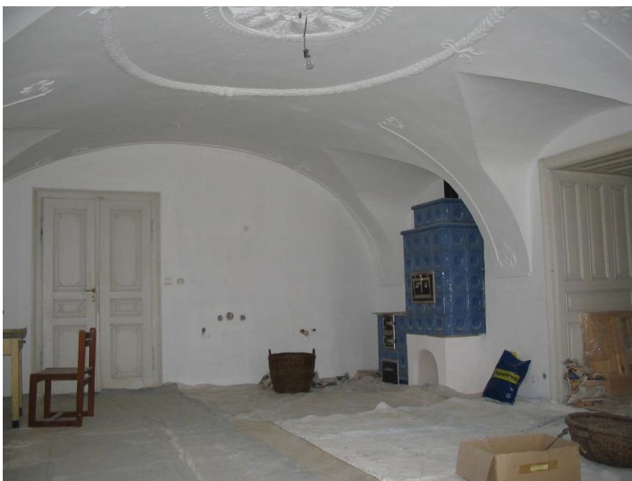
31) Kamenice čp. 22 (JI). Bohatě zdobená valená klenba s nestyčnými pětibokými výsečemi na venkovské rychtě z počátku 19. století. Podobný empírový dekor zdobil původně i fasádu domu. Foto Radim Silný, 2009.
